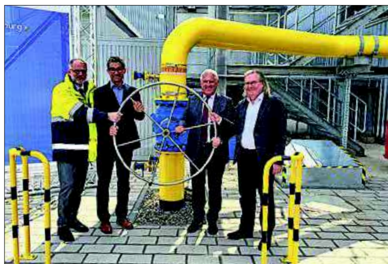
Bürgermeister Peter Pätzold nimmt das Gaskraftwerk gemeinsam mit (von links) Dirk Güsewell, Leiter Erzeugung/Portfolioentwicklung EnBW, Andre Baumann, Staatssekretär im Ministerium für Umwelt, Klima und Energiewirtschaft Baden-Württemberg, und Hans-Josef Zimmer, Mitglied des Vorstands EnBW in Betrieb. Foto: Stadt
